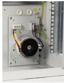
Transformatory serii TOR...
