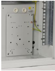
Pusta blacha montażowa
